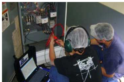
Control del rendimiento de los motores eléctricos con el Analizador dinámico de motores SKF.
